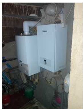
plynový kotel a elektro kotel v objektu č.p. 622 v prostoru pod schodištěm
