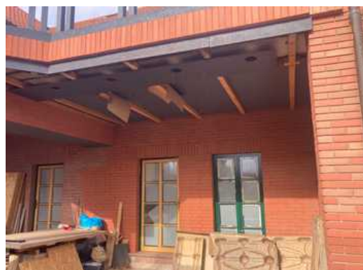
do terasy zatéká vlivem dlouhé doby rozestavění stavby (není provedena nášlapná vrstva terasy)
